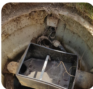
Couvercle non-étanche et non-drainé – Infiltration de racines et de terre
