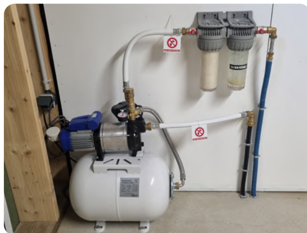
Pompe, ballon vessie et filtre secondaire
