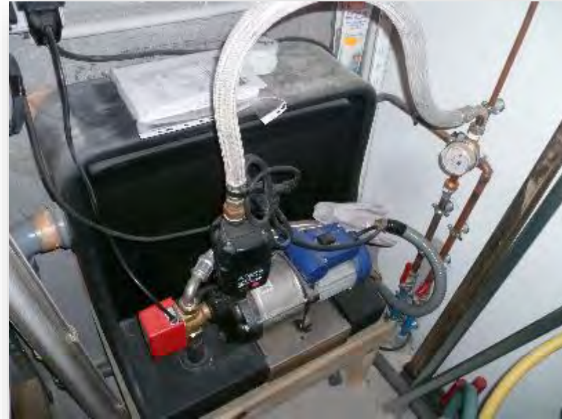
La séparation des réseaux eau de pluie/eau de ville
