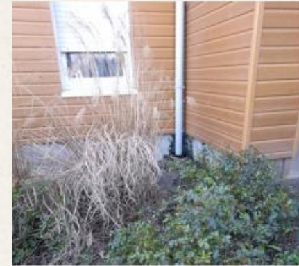
La Chapelle-Thouarault (35) : des gouttières non reliées sur la ZAC
