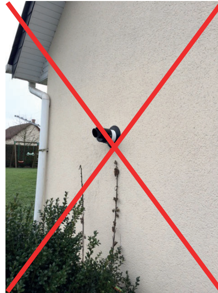
Chaudière à condensation sortie ventouse en façade visible depuis l'espace public : interdite
