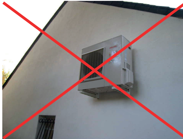
Pompe à Chaleur sans habillage visible depuis l'espace public : interdit
