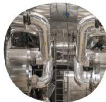
RÉCUPÉRATION DE CHALEUR FATALE
