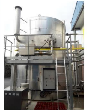
Fig. 1 : Ballon de production d'eau chaude par brûleur immergé et récupération de chaleur par stratification
