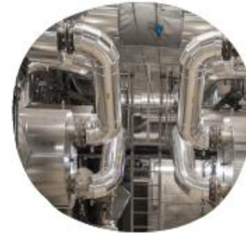
RÉCUPÉRATION DE CHALEUR FATALE
