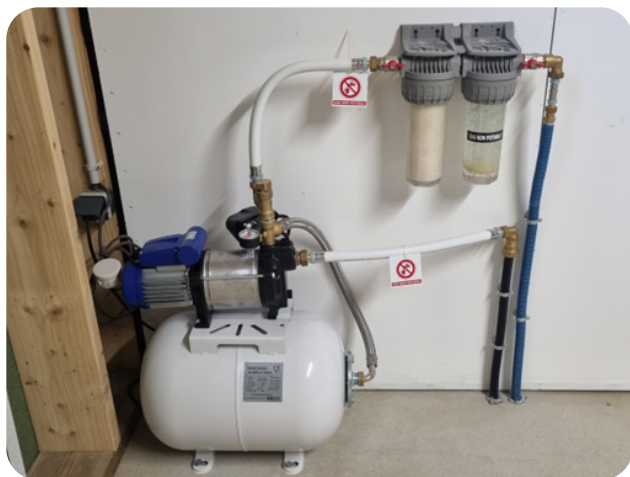
Pompe, ballon vessie et filtre secondaire.
