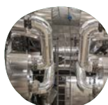
RÉCUPÉRATION DE CHALEUR FATALE
